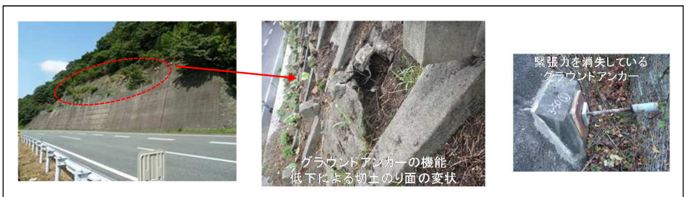
図ー3 土構造物(グラウンドアンカー)の主な変状
